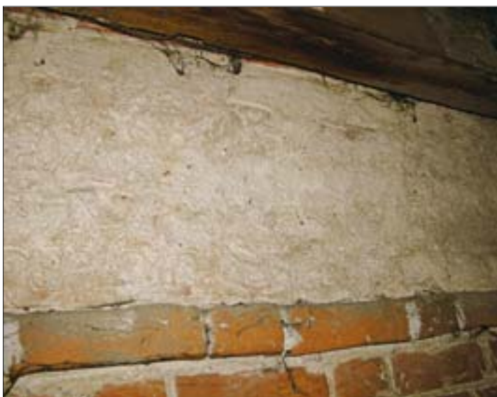
13. Gzyms podokapowy, widok rytów w dolnym pasie tynkowanego pasa gzymsu.
