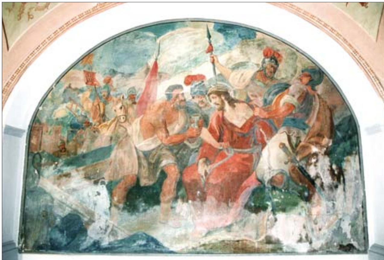
12. Kcynia. Polichromia Obnażenie Chrystusa z szat z krużganka odpustowego kościoła p.w. Wniebowzięcia NPM, widoczny efekt kapilarnego podciągania wilgoci, przebarwienia i wysolenia na tynku. Fot. D. Bręczewska-Kulesza.
