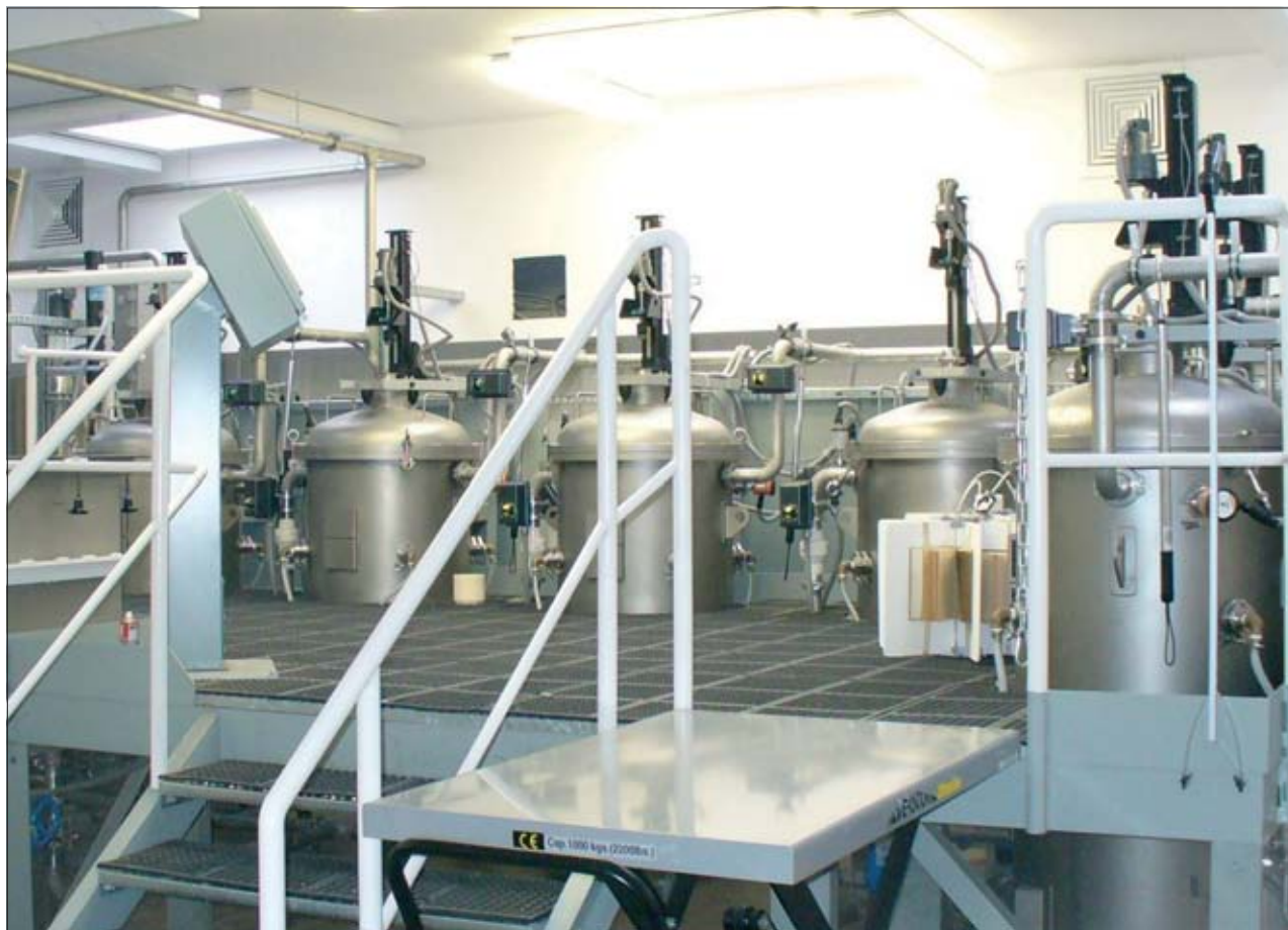
2. Instalacja Bookkeeper w Bibliotece Narodowej w Warszawie. Fot. W. Sobucki. 2. Installation of the Bookkeeper at the National Library in Warsaw. Photo: W. Sobucki.
