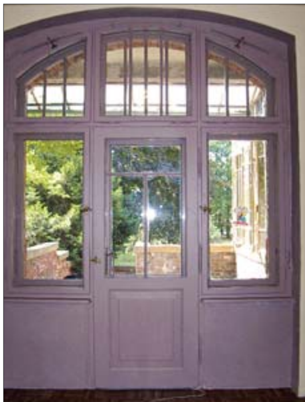
17. Stolarka drzwiowa w budynku sanatorium po renowacji w 2005 r. Fot. B. Bielinis-Kopeć.
