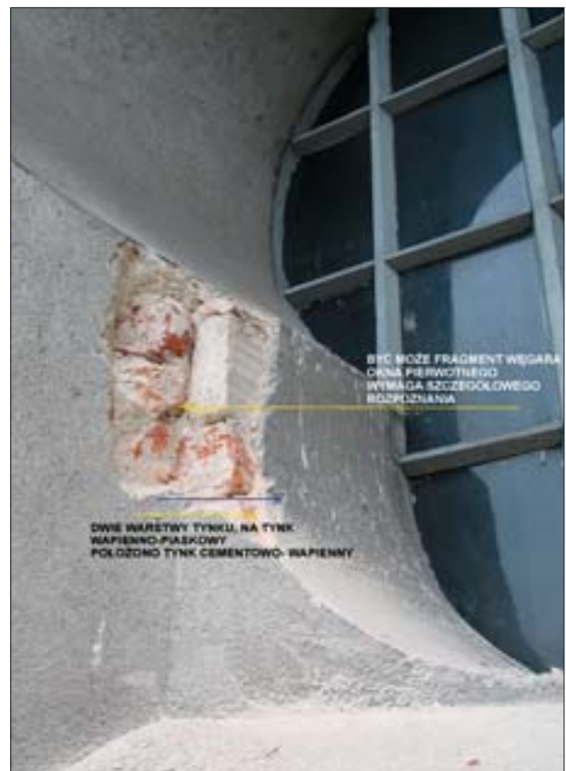
13. Rozeta w ścianie wschodniej prezbiterium. Wstępne rozpoznanie.
