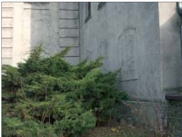
9. Dobrzany, elewacja zachodnia kościoła z fragmentem wieży oraz śladami po partii dolnych okien, 2006 r. Fot. autorka.
