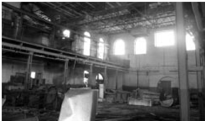
Fot. 4. Główna hala produkcyjna d. cukrowni z lat 70. XIX wieku, przebudowana w 1922 r. – nie użytkowane i zdewastowane wewnątrz. Foto autora 2010 r.
