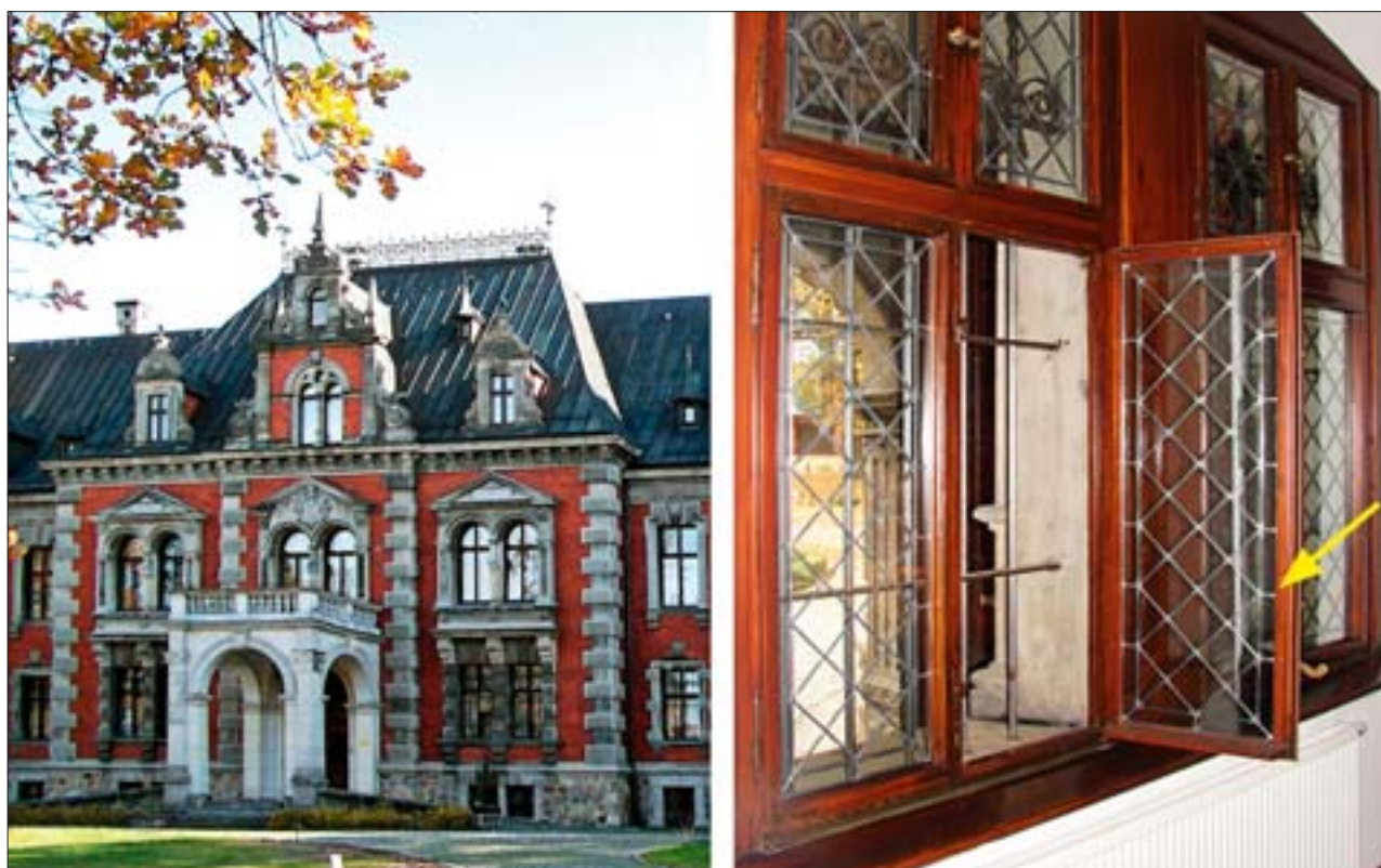
18. Pławniowice, pow. gliwicki. Pałac neorenesansowy z 1885 r., adaptowany na Ośrodek Edukacyjno-Formacyjny Diecezji Gliwickiej, jest przykładem wzorowo przeprowadzonych prac konserwatorskich z zadbaniem o każdy oryginalny element (po lewej), w tym także o okna (po prawej). Zostały one poddane renowacji z jednoczesnym wprowadzeniem szyb podwójnych (zespolonych) w skrzydła wewnętrzne i umocowane listewkami (strzałka). Wielka zasługa gospodarza ks. proboszcza dr. Krystiana Worbsa. Fot. A. Szadkowska.
