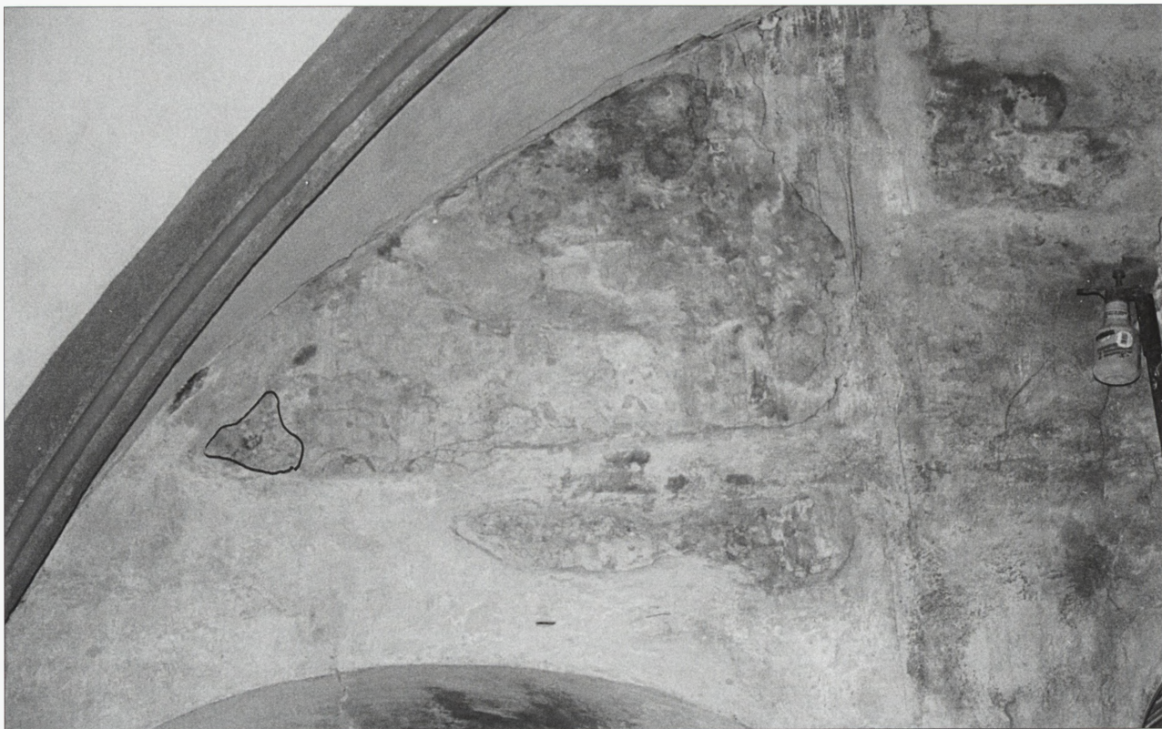
6. Ściana północna. Stan przed konserwacją, październik 1999. Widoczne znikome fragmenty polichromii w formie przypominające motywy roślinne, podobne do tych na sklepieniu. Czarną linią oznaczono fragment zachowanej polichromii. Wszystkie zdjęcia K. i A. Jarkiewicz 6. Northern wall, state prior to conservation, October 1999. Visible small fragments of the polychrome resembling plant motifs, similar to those on the vault. Black line marks a fragment of the preserved polychrome. All photos by K. and A. Jarkiewicz
