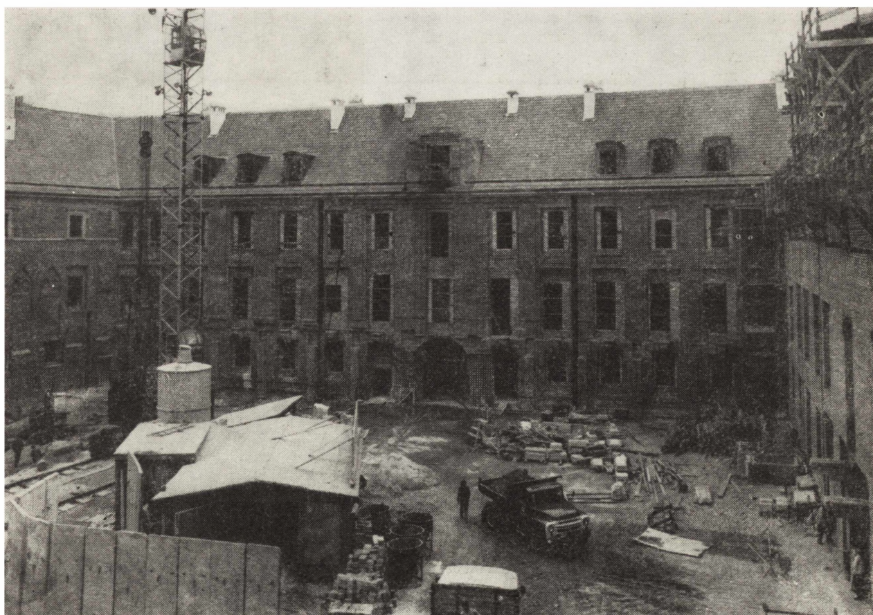
14. Elewacja skrzydła południowego od strony Dziedzińca Wielkiego, stan z 1974 r. (fot. R. Kazimierski) 14. Elevation of the south wing from the side of the Great Courtyard, 1974 condition
