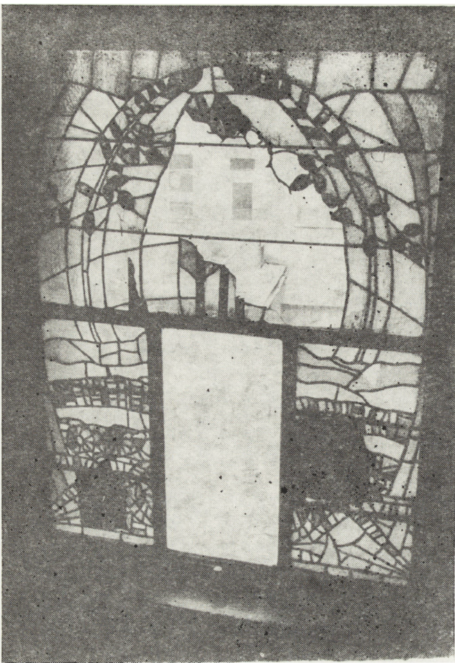
4. Witraż o motywach floralnych w kamienicy przy ul. Długiej 10, ok. 1906 r. Brakującą środkową kwaterę w dolnej partii witrażu zastąpiono szkłem przezroczystym; w górnej partii – ubytek znacznej części powierzchni witrażu, zniszczona konstrukcja metalowa (fot. R. Kisiel)
