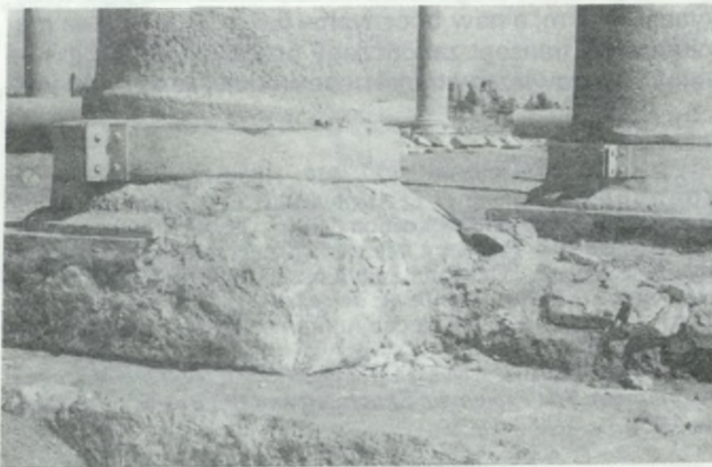
4. Stan zachowania kolumn
