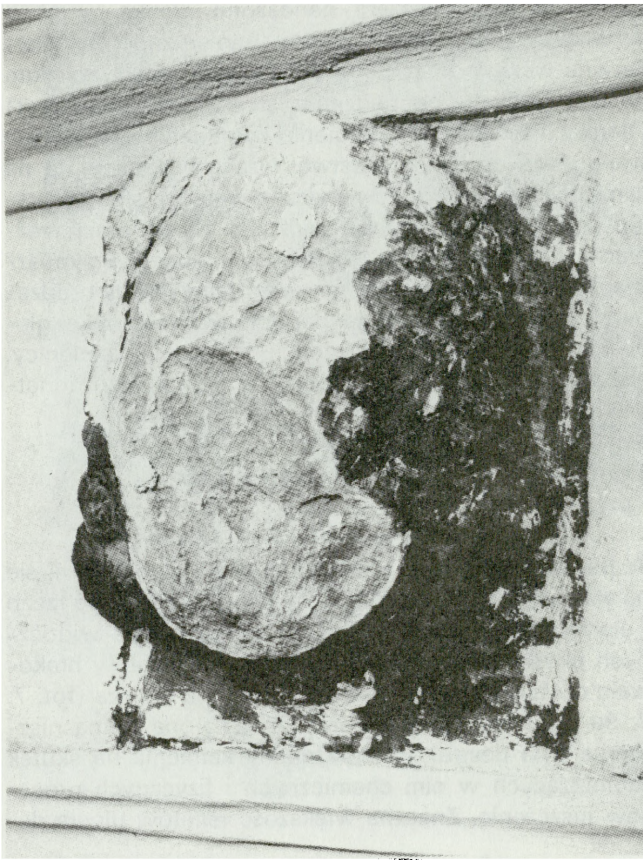
9A. Fasada kamienicy przy ul. Piwnej 1 w Gdańsku. Rzeźba przed konserwacją 9A. The facade of the house at 1 Piwna Street in Gdańsk. A sculpture before conservation.
