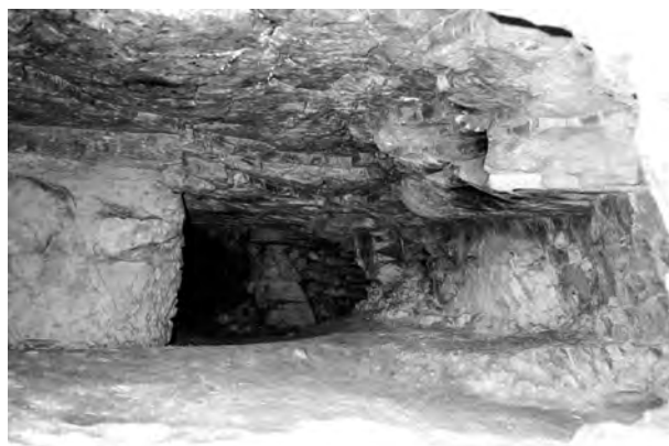
5. Niedobra metoda zabezpieczeń może czasami przynieść więcej szkody niż pożytku
