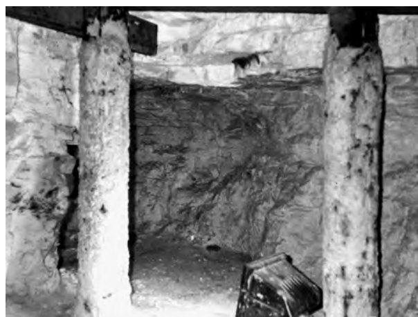
3. Zabezpieczenia trasy turystycznej wymagają już miejscami remontu
