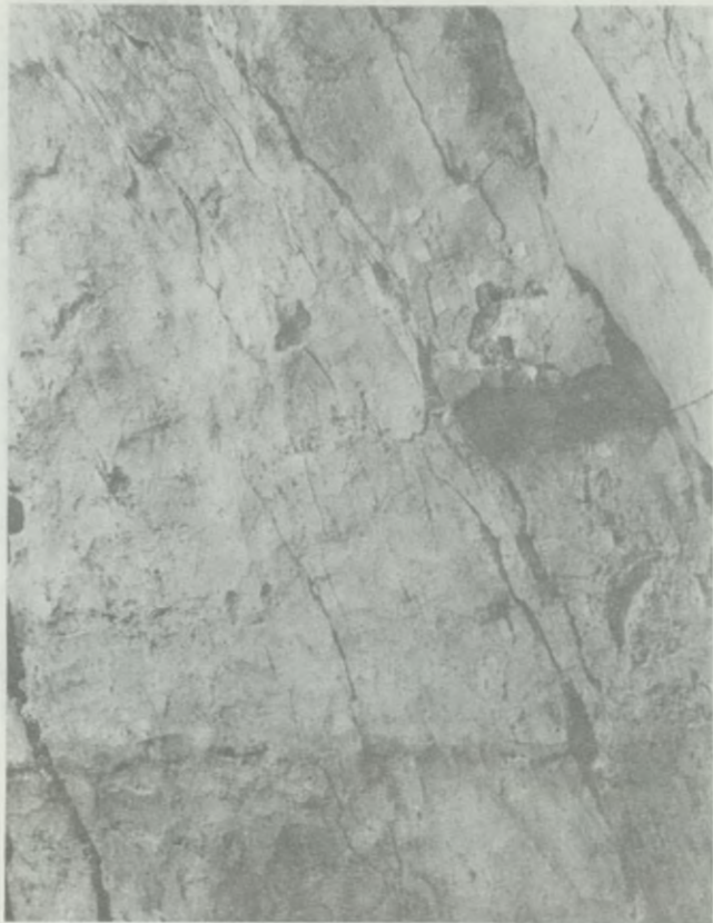
12. Południowo-wschodnia część sklepienia absydy, spękanie odspojonych warstw tynku ( Z. Starzyński, 1983)
