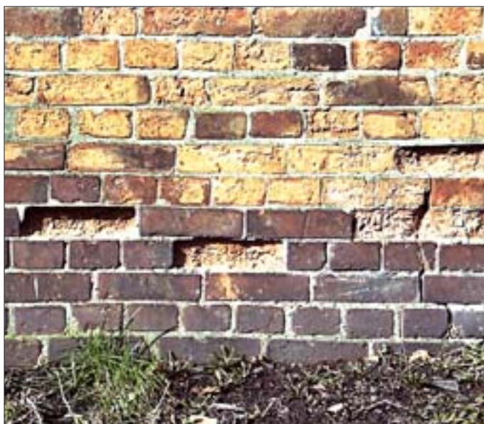
19. Zniszczone cegły wskutek zastosowania do spoinowania szerszej i mocnej zaprawy cementowej. Fot. W. Domasłowski. 19. Brick damaged due to the application of dense and strong lime mortar for binding. Photo: W. Domasłowski.
