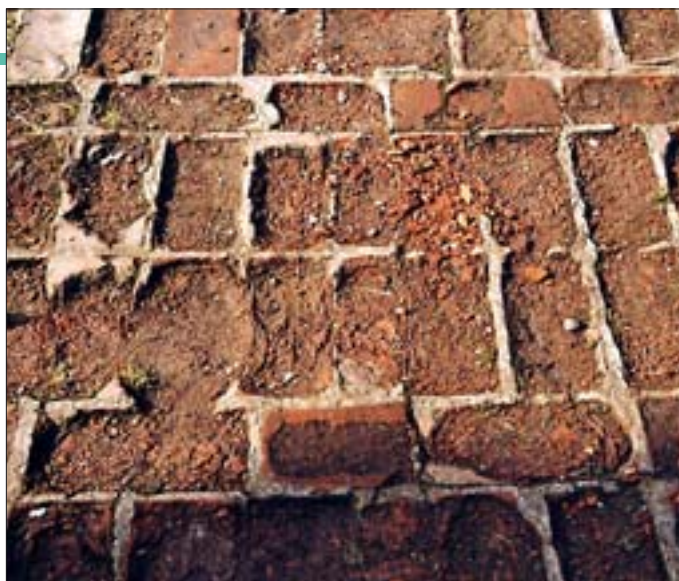
20. Zniszczone cegły chodnika wskutek wyspoinowania go szczelną i mocną zaprawą cementową. Fot. W. Domasłowski. 20. Pavement bricks damaged due to the application of dense and strong lime mortar for binding. Photo: W. Domasłowski.
