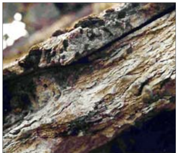
3. Niszczący beton. Fot. W. Domasłowski. 3. Concrete undergoing damage. Photo: W. Domasłowski.
