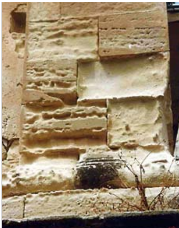
17. Niszczenie elementów kamiennych przez wiatr. Fot. W. Domasłowski. 17. Stone elements damaged by wind. Photo: W. Domasłowski.
