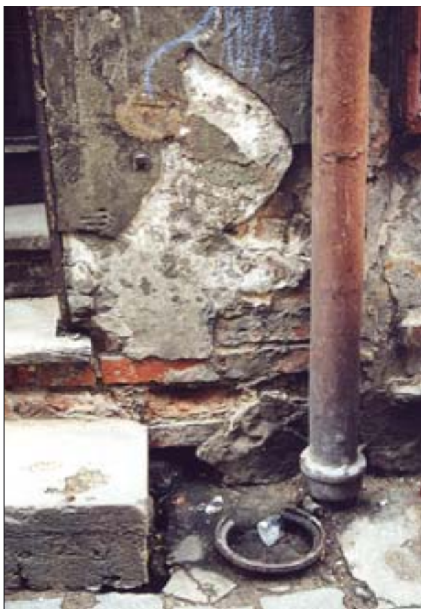
9. Tynk i mur niszczone przez wodę gruntową. Fot. z archiwum autora.
