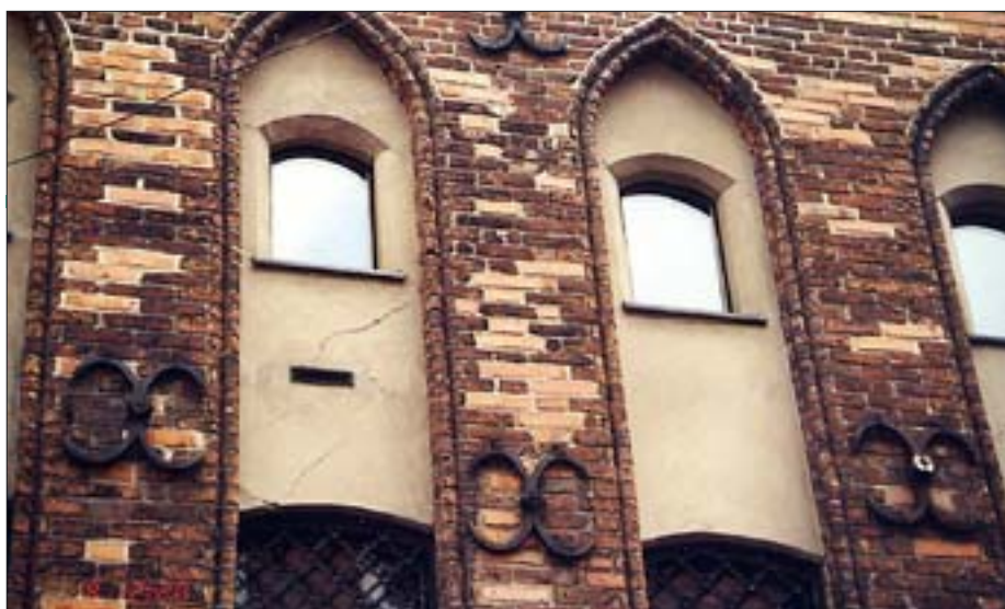
18. Fasada domu ze wstawkami nowych cegieł. Fot. W. Domasłowski. 18. Facade of house with inserts of new bricks. Photo: W. Domasłowski.
