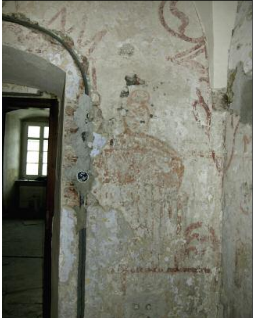
33. Cella nr 3, malowidła ściany wschodniej – stan przed konserwacją. 33. Cell no. 3, murals on the east wall – state prior to conservation.
