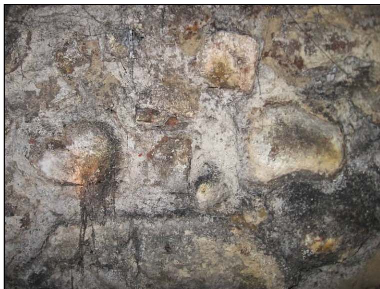
Ryc. 8. Fragment kamiennej ściany piwnic jednej z kamienic. Wysolenia, wykwyty i silne zawilgocenia ścian
