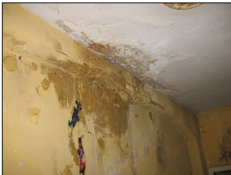
Ryc. 9. Fragment ściany na piętrze jednej z kamienic. Zawilgocenie ściany i stropu z powodu nieszczelności kosza
