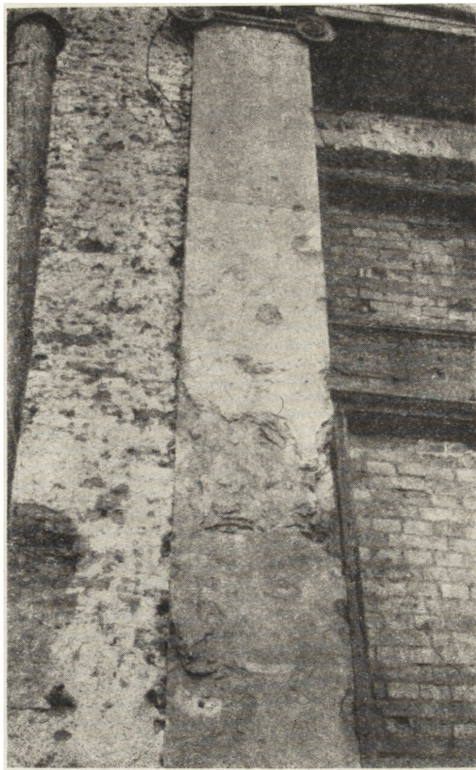
Ryc. 296. Teatr Wielki w Warszawie — pilaster elewacji północnej. Przykład nieprawidłowego montażu: płyty osadzone prostopadłe do zalegania kamienia w skale.
