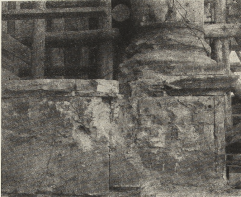
Ryc. 208. Teatr Wielki w Warszawie — baza kolumny z portyku I piętra. Widoczne uszkodzenia od uderzeń pocisków oraz objawy luszczenia się kamienia.
