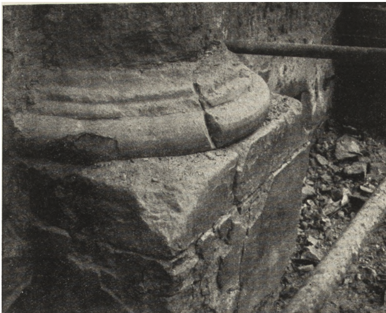
Ryc. 299. Teatr Wielki w Warszawie — baza dorycka. Wpływy atmosferyczne oraz wilgoć kapilarna spowodowały wylugowanie spoiwa. Rezultaty widoczne na zdjęciu.
