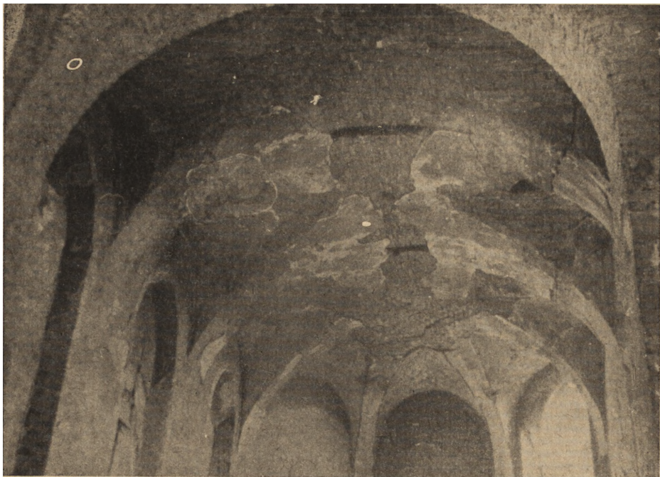
Ryc. 247. Sklepienie prezbiterium — stan zniszczenia.
