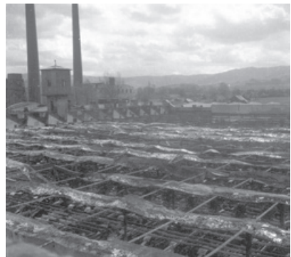
Widok od strony północnej na spaloną halę tkalni. W głębi po lewej stronie za kominem widać pozbawiony dachu budynek siłowni. Zdjęcie A. Stuglika z AP Oświęcim.
