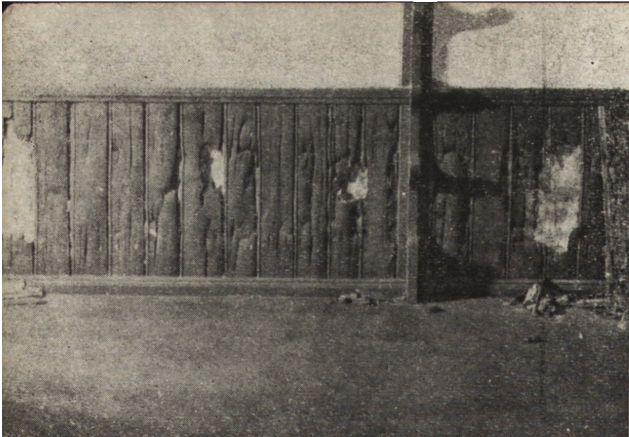
Ryc. 238. Boazeria z powozowni zniszczona przez grzyb.
