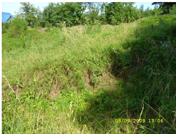
Ryc. 15. Podcięcie erozyjne w obrębie osuwiska na Stoku pod Baranem w Wieliczce (fot. P. Krzyk)
