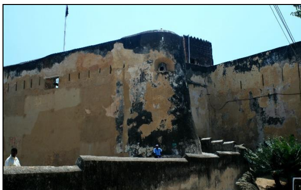
Ryc. 1a. Wzniesiony w latach 1593-1596 przez Portugalczyków Fort Jesus w Mombasie (Kenia) Źródło: fot. Jacek Górny, 2009
