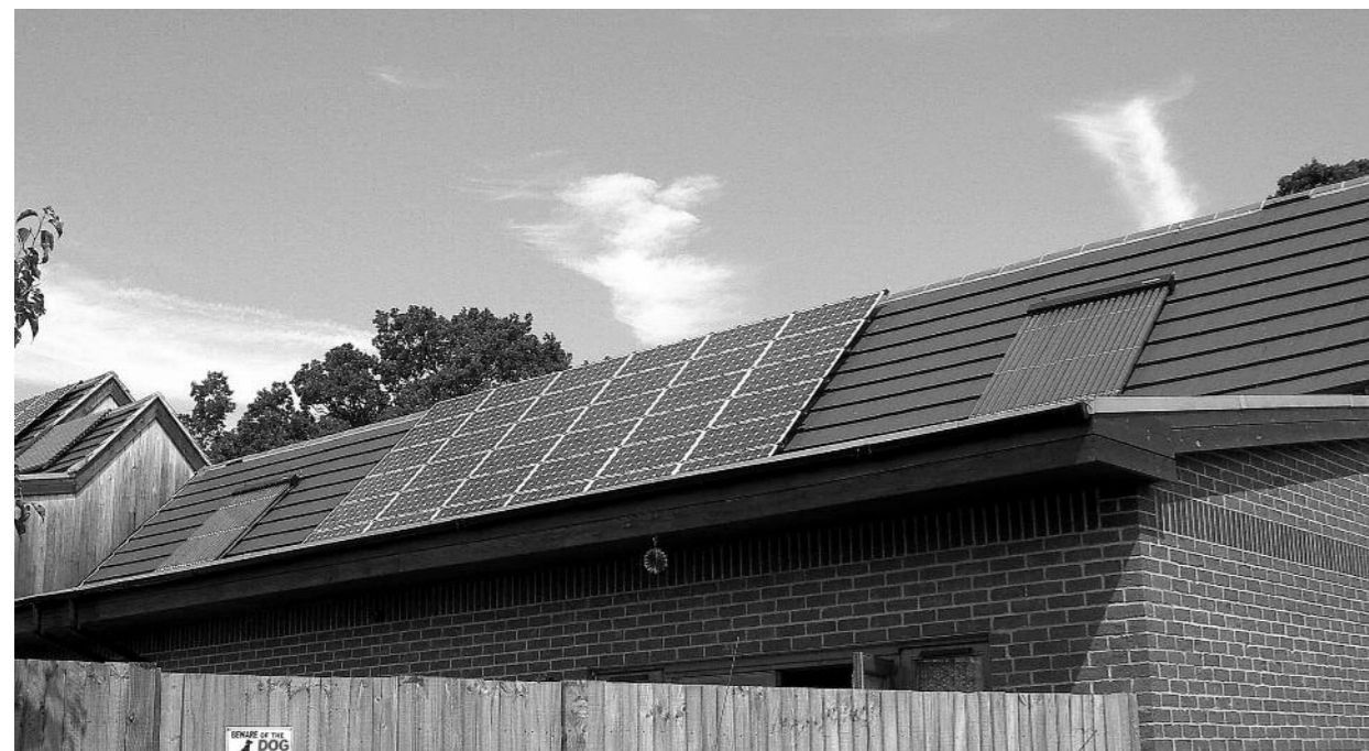
Ogniwa fotowoltaiczne i kolektory słoneczne w zespole mieszkaniowym w Havant Photovoltaic cells and solar collectors in a residential complex, Havant
