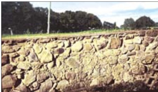
11. Wenecja k. Žnina. Ruina zamku. Sztywna korona murów wykonana z betonu. Fot. J. Tajchman.
