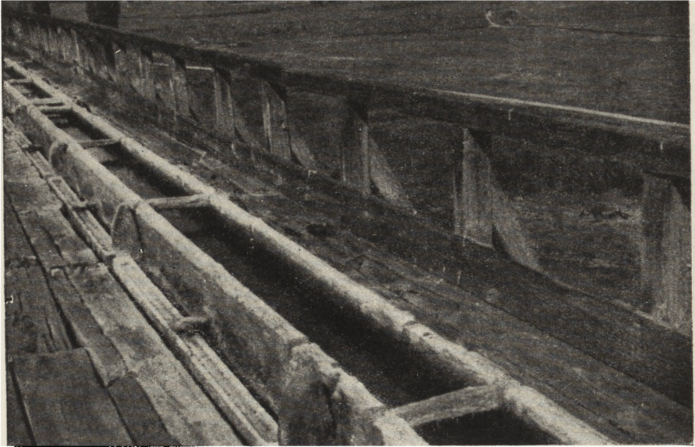
Ryc. 214. Główne koryto do solanki umieszczone na górnym poziomie tężni nr 1.
