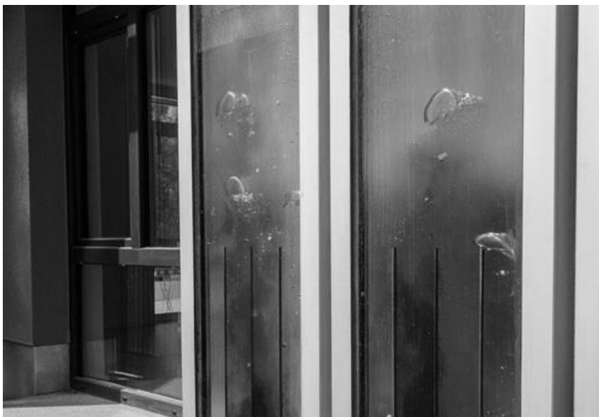
Fotografia 3. Algi na elewacji budynku BIQ.
