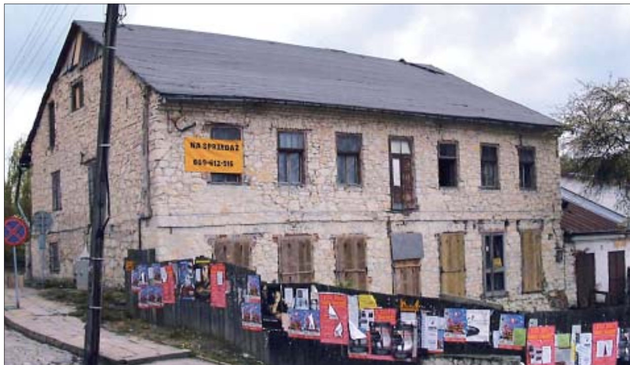
7. Od wielu lat w samym centrum Kazimierza (pomiędzy rynkiem a farą) stoi opuszczony budynek dawnego Hotelu Polskiego. Fot. B. Szmygin. 7. The abandoned building of the former Polski Hotel has been standing for years in the very centre of Kazimierz. Photo: B. Szmygin.
