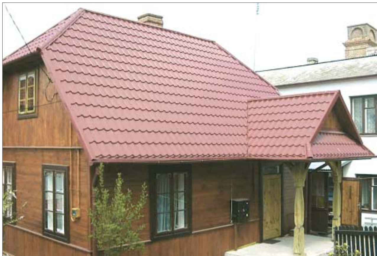
15. W wielu drewnianych domach tradycyjne pokrycia zastępowane są nowoczesnymi materiałami. Fot. B. Szmygin. 15. Traditional wooden roofs of many houses are being replaced by modern material. Photo : B. Szmygin.
