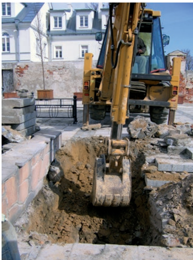
Ryc. 13. Sandomierz, m. pow., stan. 1 (tzw. Wzgórze Miejskie) – stanowisko wielokulturowe, w tym miasto średniowieczne. Przykład stanowiska niszczonego przez komunalne inwestycje infrastrukturalne (budowę instalacji wodociągowo-kanalizacyjnych) (fot. M. Bajka)
