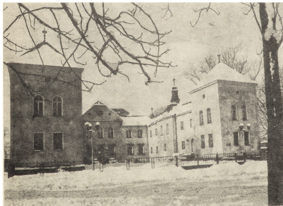
11. 12. Sosnowiec, zamek sielecki z 1620 r., widok od południowego wschodu, stan podczas prac konserwatorskich (fot. A. Kudła, 1978) i po konserwacji (fot. W. Cwikliński, 1983)
