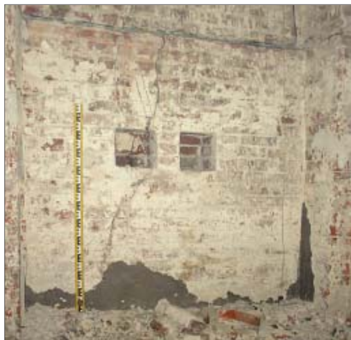
15. Dwie nisze rozpoznane w południowej ścianie prezbiterium. 15. Two niches identified in the southern presbytery wall.
