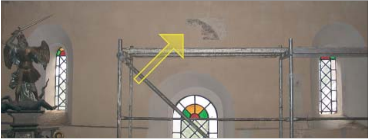
9. Odsłonięte, częściowo skute nadproże okna środkowego ściany południowej nawy. 9. Partially disclosed lintel of the central window in the southern nave.
