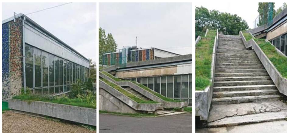
Il. 9. Pawilony wystawowe „Cepelia” w Częstochowie autorstwa Włodzimierza Ściegiennego, stan obecny (zdj. archiwum własne, fot. E. Malec-Zięba).
