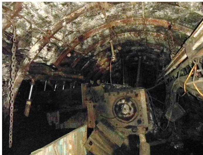
Rys. 1. Przykład ochrony skrzyżowania ściana–chodnik przy pomocy krótkiego kotwienia (Duży i in. 2017b)
