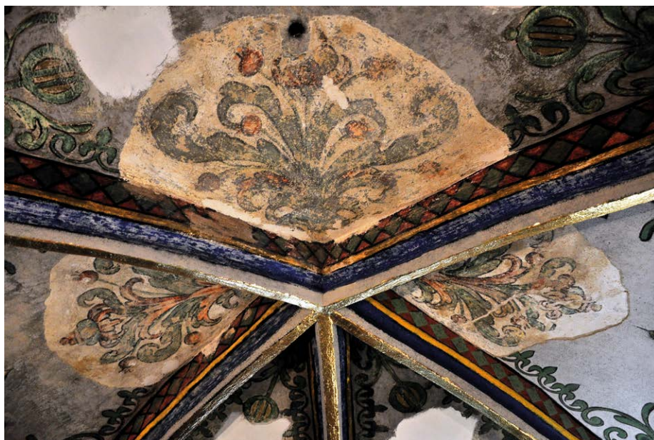
Il. 9. Relikty roślinno-kwiatowej dekoracji na sklepieniu prezbiterium kościoła Św. Trójcy w Krośnie (stan po odkryciu). Fot. P. Łopatkiewicz
