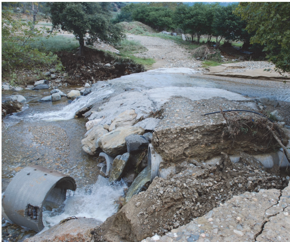
Ryc. 13. Zniszczona przez potok droga położona na zboczach doliny Anthemousa, nieopodal profilu 5 (wg ryc. 4)
