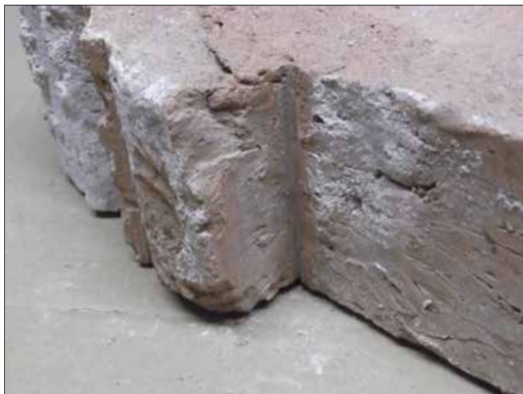
Ryc. 3. Zarysowania powierzchni bocznej sięgacza i ślad po drucie. Widoczne są też ślady spękania (fot. W. Lajsner)
