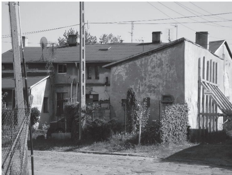
Ryc. 3. Budynek mieszkalny przy ul. Mącznej – grożący zawaleniem
