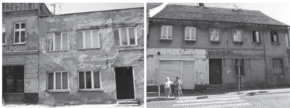
Ryc. 2. Zniszczone elewacje budynków przy ul. Bydgoskiej
