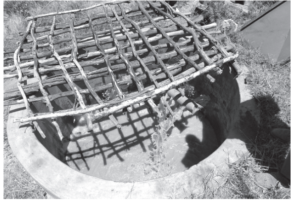
Ryc. 6. Śluza służąca do upustu wody z tamy, fot. M. Szupejko
