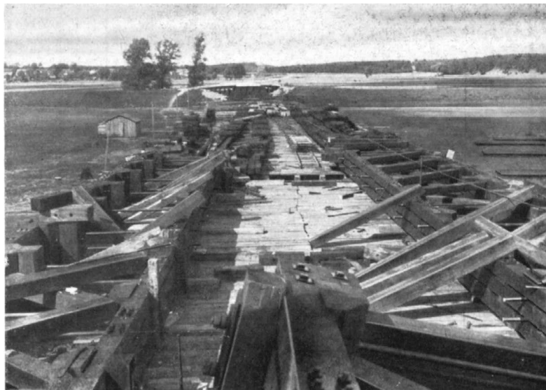
Ryc. 4. Ustawianie kratownic Howe'a na rusztowaniach mostu w Krobielewku, źródło: Pommerrenig, Holzbrücke , s. 162.
