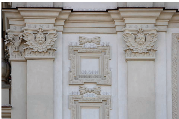
19. Kościół franciszkanów w Zamościu, fragment dekoracji elewacji wschodniej, stan w roku 2021. Fot. Aleksander Stankiewicz
