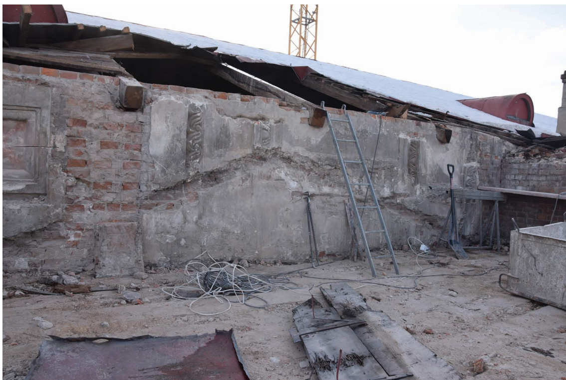
13. Kościół franciszkanów w Zamościu, widok na odkryte relikty dekoracji nawy głównej, stan w 2020 r. Fot. Sebastian Ćwierz
