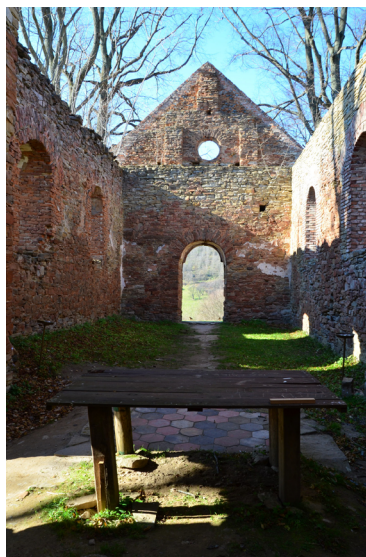
Il. 16. Wnętrze ruin cerkwi w Krywem, widok w kierunku nawy głównej i wejścia od prezbiterium, październik 2021, fot. K. Zielińska.
