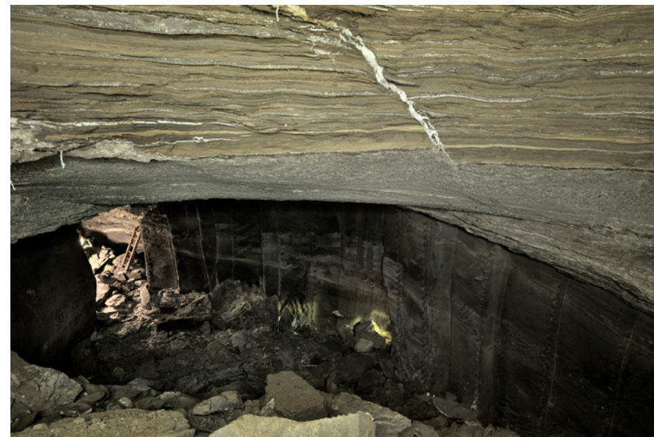
16. Komora Ksawer Dolny . Uszkodzenie solnej łuski ochronnej powodujące postępujący obrwał skał płonnych ze stropu (fot. K. Kozłowski)
