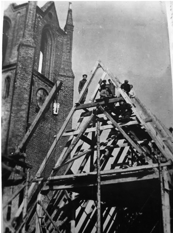
Na ilustracji: Odbudowa więźby dachowej kościoła w Kisielicach w 1958 roku (widok od strony wschodniej) 44 .
