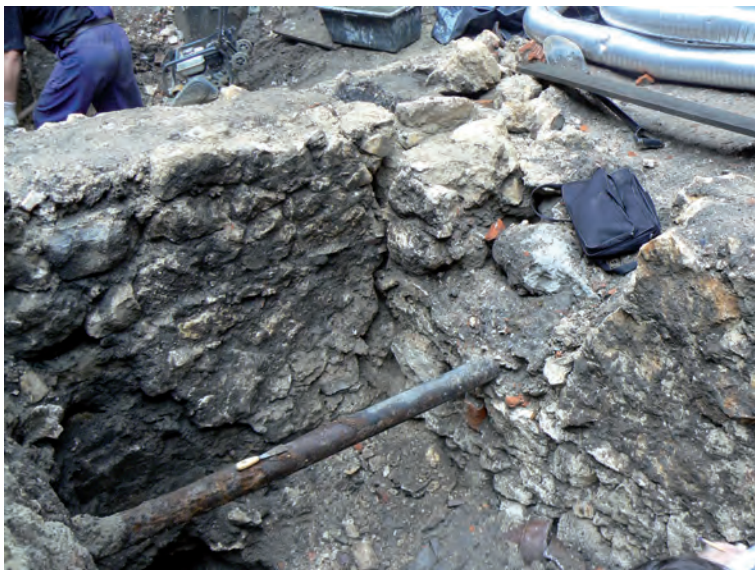
II. IV. Dziedziniec Collegium Maius. Wykop kanalizacyjny w strefie piwnicy pod dziedzińcem, przy skrzydle północnym (na zewnątrz tejże). Po lewej widoczny jest zachodni mur podłużny (XIV/XV wiek lub początek XV) z pionowym pęknięciem w narożniku, po prawej mur poprzeczny (południowy) ww. piwnicy (pierwsza połowa wieku XV). Fot. M. Maciaszek
