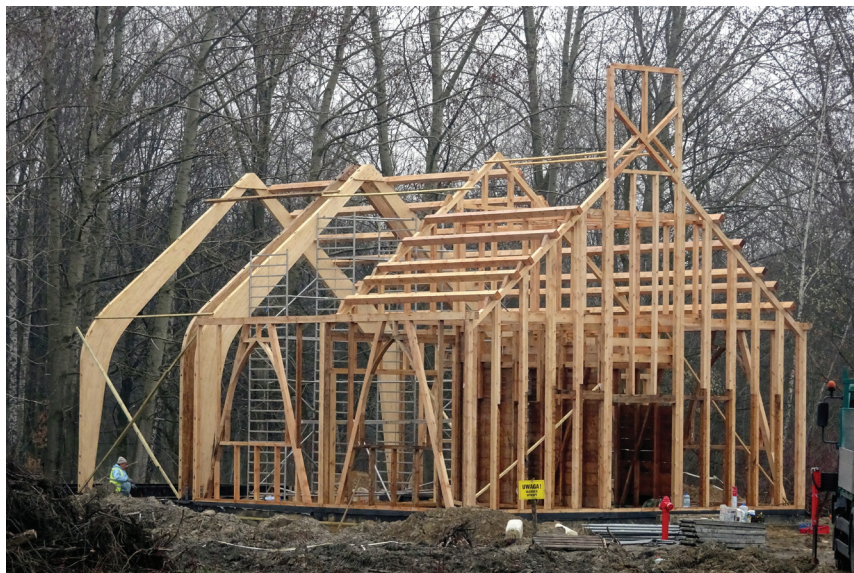
Fot. 5. Montaż konstrukcji kościoła z Bytomia-Bobrka, marzec 2017 roku. Widoczne dźwigary nowe (jaśniejsze) i para dźwigarów oryginalnych
