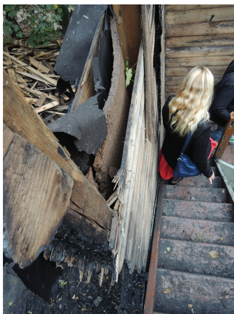
Fot. 7. Kościół z Bytomia-Bobrka w trakcie rozbiórki. Widoczna budowa ściany kościoła z wypełnieniem z papy i płyt pilśniowych
