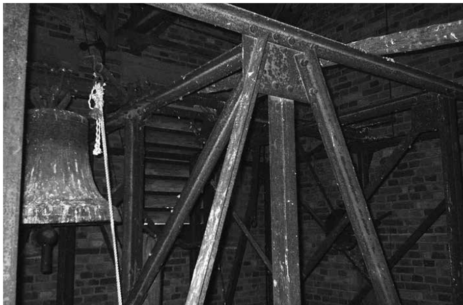
Stary Dwór (powiat międzyrzecki) – stalowa konstrukcja oraz dzwon zanieczyszczony ptasimi odchodami
