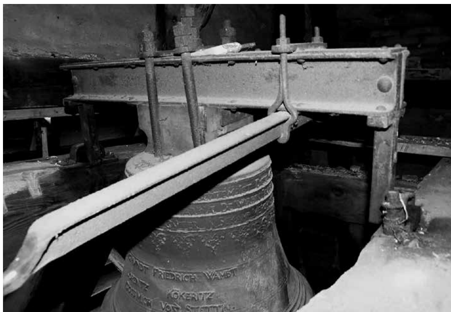
Międzylesie (powiat świebodziński) – drewniana podkładka jako element naprawy dzwonu z uszkodzoną koroną
