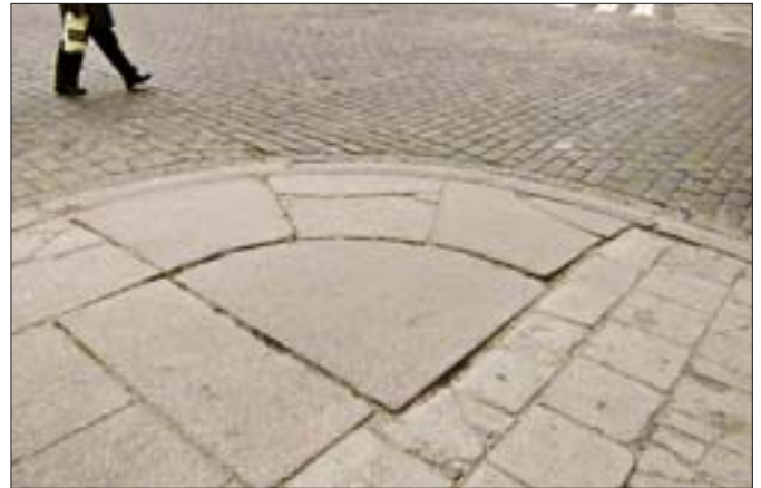
18. Szczecin, al. Jedności Narodowej/Wielkopolska, narożnik chodnika z nawierzchnią wykonaną z płyt granitowych, stan z 2004 r. 18. Szczecin, Jedności Narodowej/Wielkopolska Avenue, pavement quoin with surface made of granite slabs, state in 2004.
