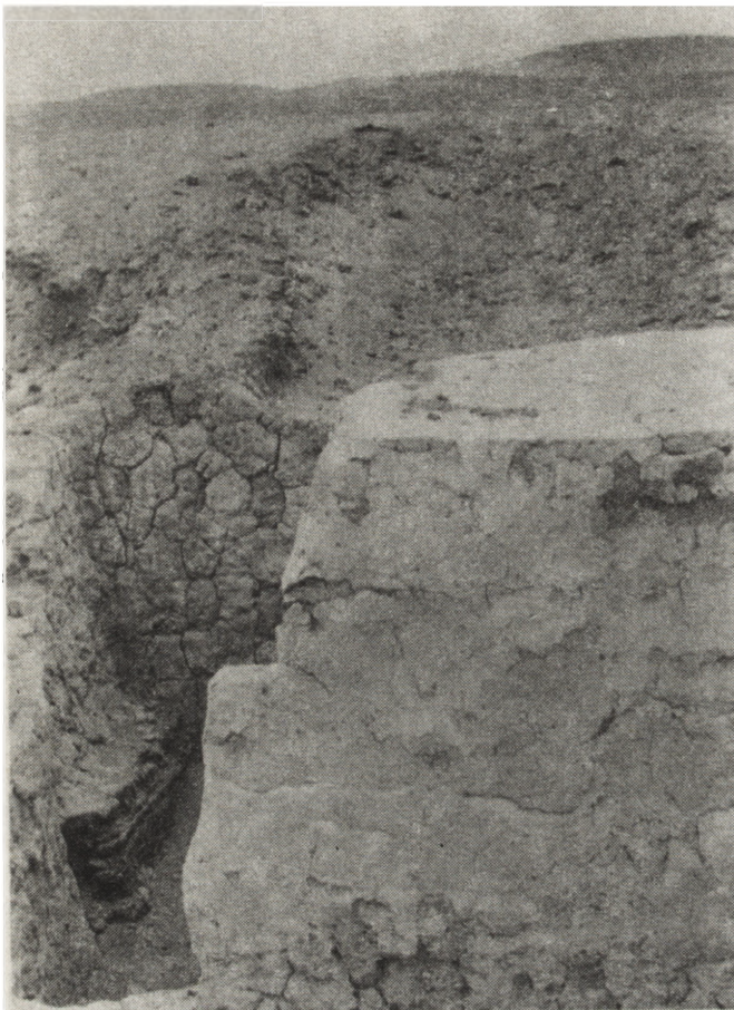
6. Fragment muru konserwowanego przez Włochów w 1986 r.; na zdjęciu widoczna odspajająca się zaprawa cementowa 6. Fragment of wall conserved by Italians in 1986; in photograph the loosening cement mortar is visible
