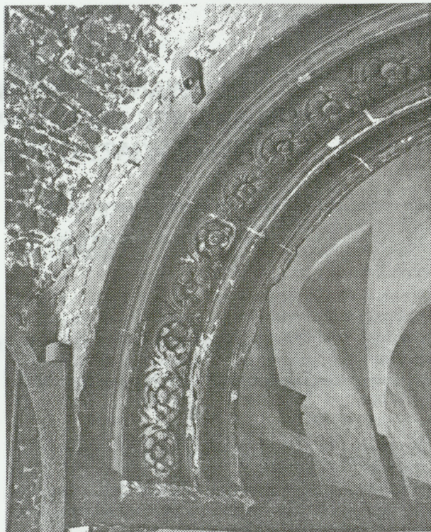
1. Arkada renesansowa Franciszka Florentczyka oddzielająca obie części sieni wjazdowej, stan przed konserwacją — charakterystyczne zniszczenia związane z obecnością soli rozpuszczalnych. Fot. P. Stępień
