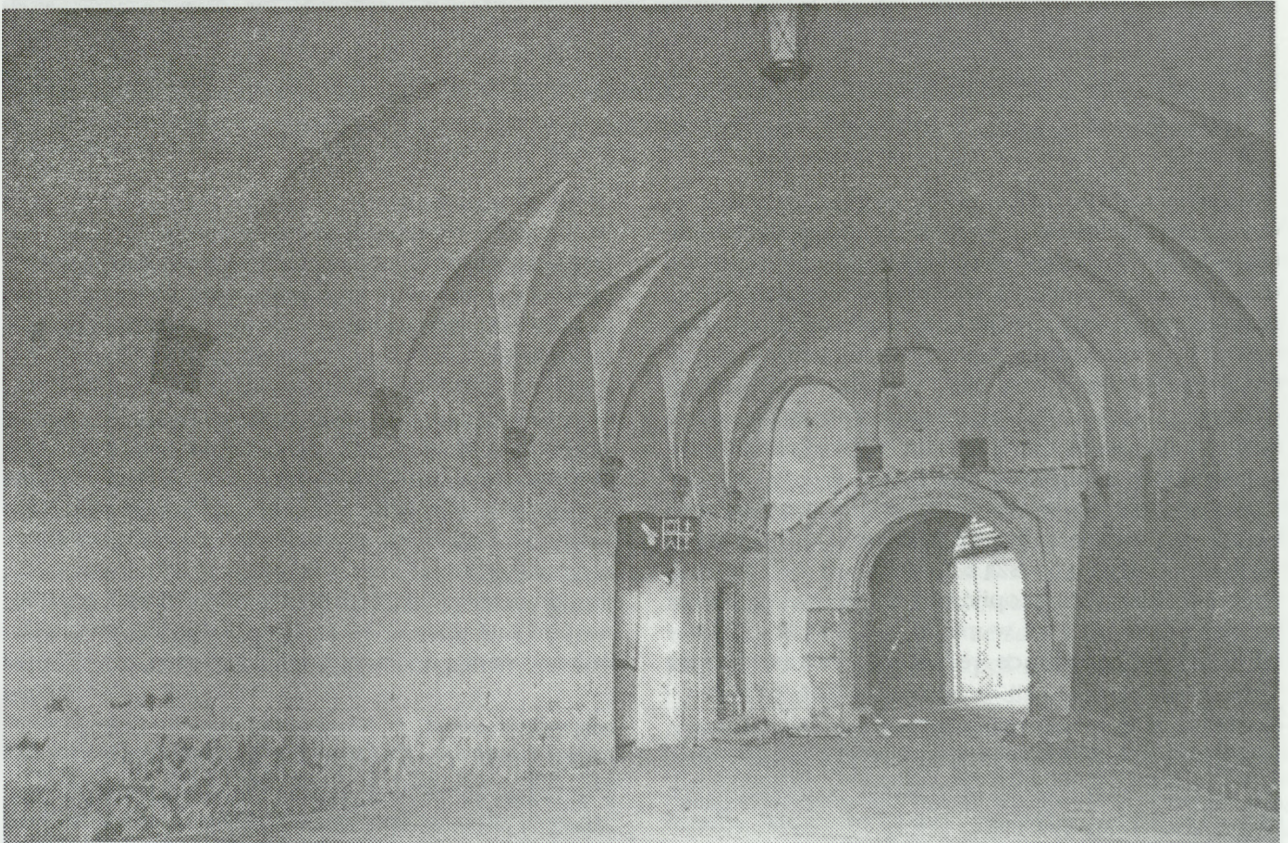
2. Część zachodnia sieni wjazdowej, stan przed konserwacją (1993 r.). Fot. P. Stępień 2. Western part of the Entrance Hall, before conservation (1993). Photo: P. Stępień
